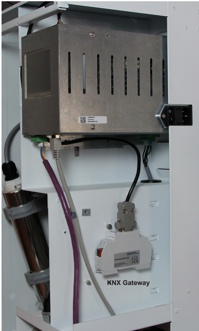
Abb. 1: KNX Gateway eingebaut
