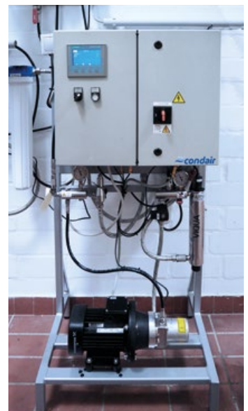
Hochdruckpumpe und Wasseraufbereitung Condair MLP 300
