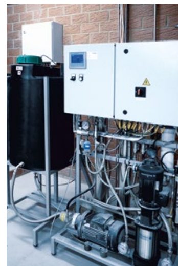
Wasseraufbereitung und Hochdruckpumpe des Condair ML Systems
